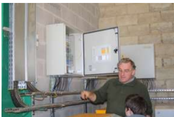
Présentation des onduleurs de l'installation photovoltaïque par Monsieur Cannesson , agriculteur à Nuncq-Hautecôte
